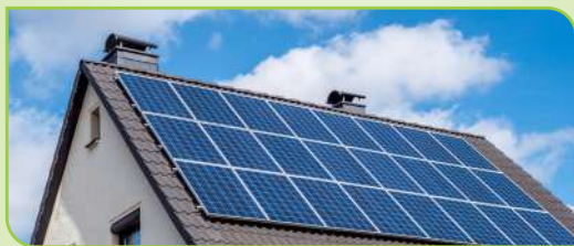
Мал. 120. Сонячні батареї на даху приватного будинку
