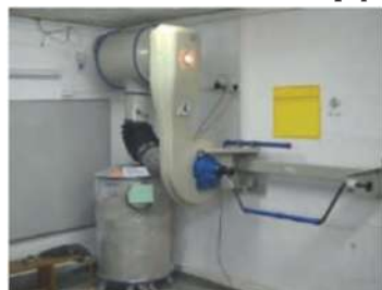
Іл. 28.5. Фільтровентиляційний агрегат
