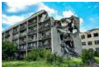
Іл. 44.11. Руїнування будівлі внаслідок обстрілу
